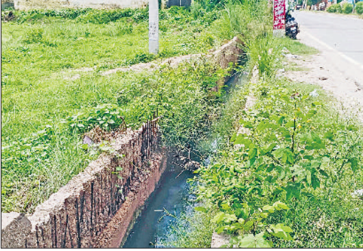
बहादुरगढ़। झज्जर रोड पर खुला पड़ा गहरा नाला,
